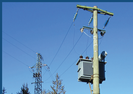
Cabina vedla sön stangia Som Triac
