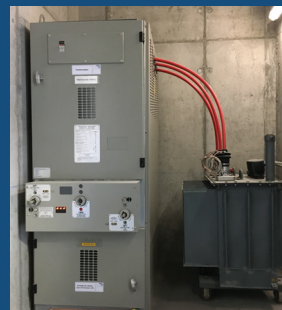
Cabina Auto Alta Badia daite
