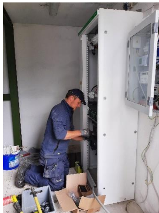
La cabina da Seres vëgn arjignada ite danü
